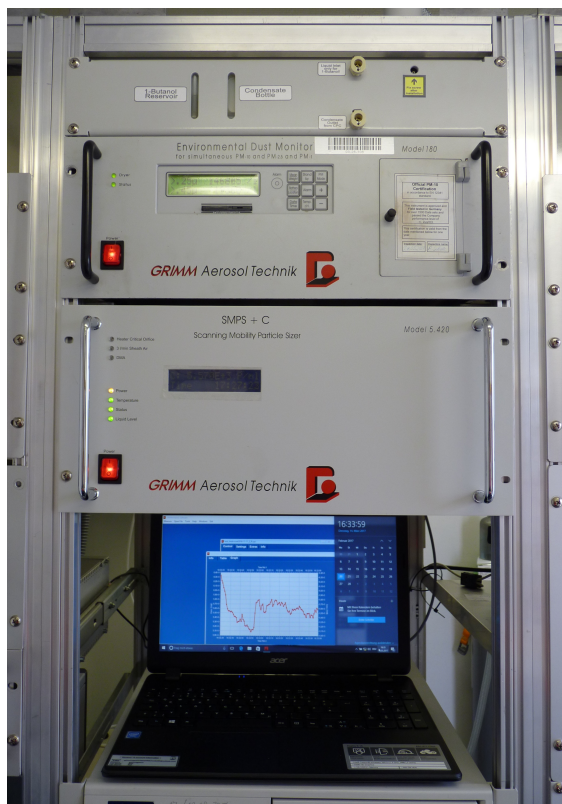
Abbildung 18: UFP-Messgerät in der stationären Luftgütemessstation der FBB.
