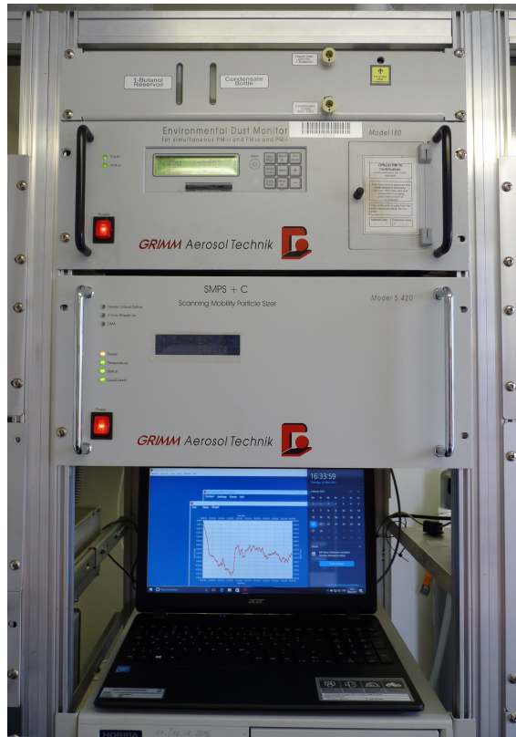
Abbildung 18: UFP-Messgerät in der stationären Luftgütemesstation der FBB
